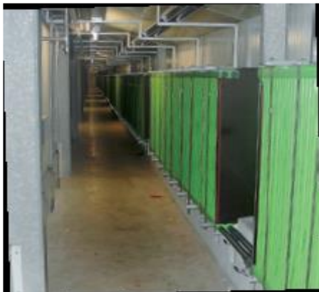
Foto 1: Gang langs zijwand van de stal met warmtewisselaars (Terra Sea)
